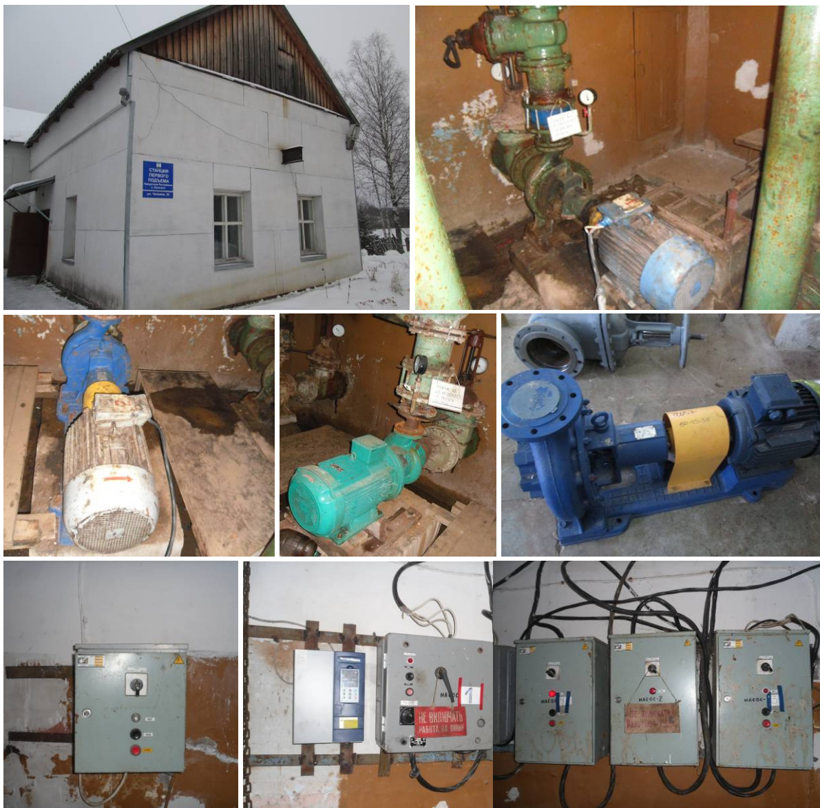
Рис. 1.7. Здание НСПП и насосное оборудование
